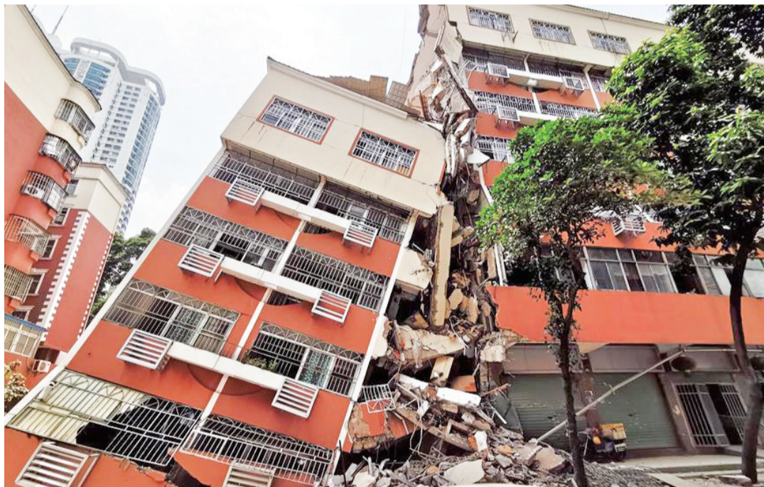
深圳楼房沉降事故现场。新华社发
