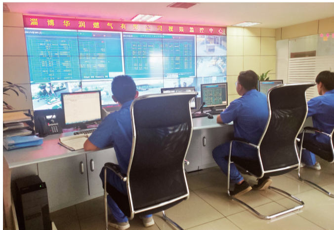
淄博华润燃气有限公司视频监控中心。
