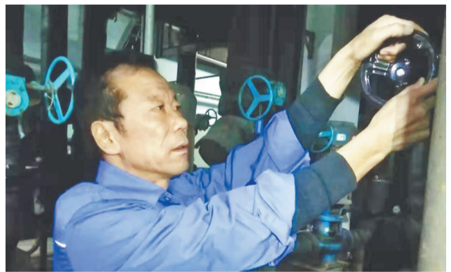
杨锋在调节新华制药总部中央空调系统总管路阀门。
