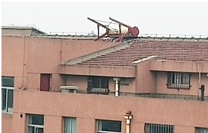
楼顶上歪倒的太阳能热水器。
