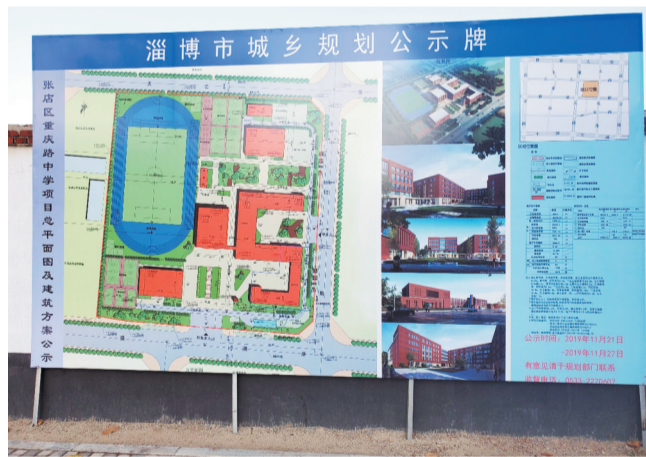
在重庆路中学工地旁，立起了项目总平面图以及建筑方案公示牌，公示牌上显示容纳班级为48+8。
