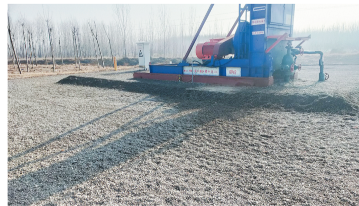
省道316附近一处油井,井口附近的裸露土地采用铺设碎石的办法防尘固土。
