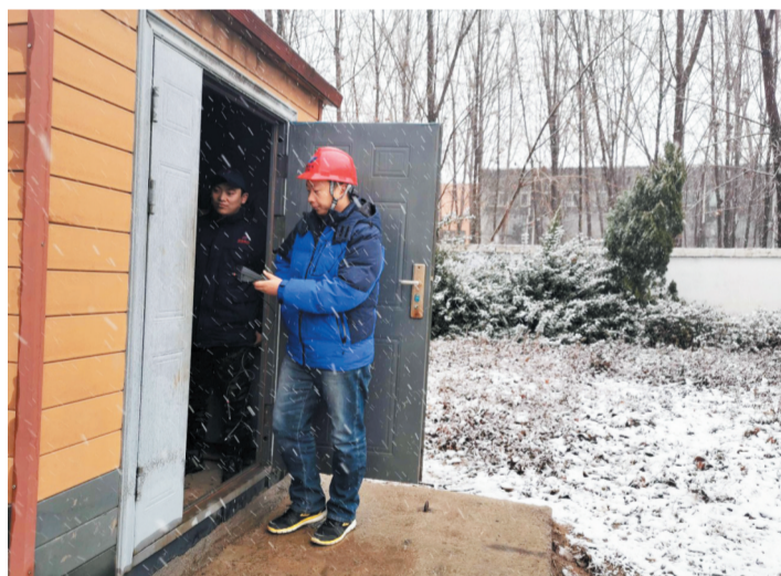
1月7日,大雪纷飞的天气里,华电淄博公司员工忙碌在供暖现场。
