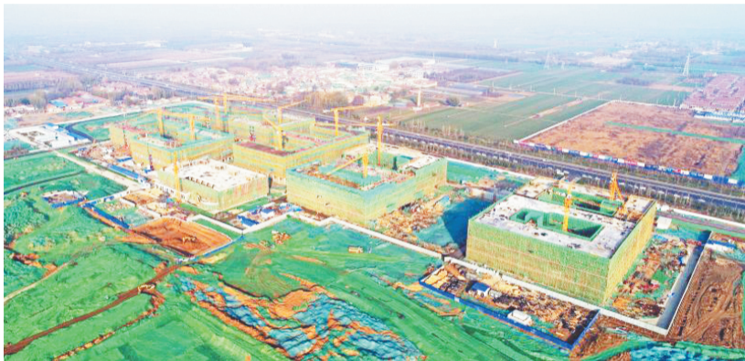
建设中的淄博大学城。淄博大学城是2019年度省、市重大项目之一,大学城一期建设项目位于淄博市经济开发区,建成后在校学生规模约16000人。
