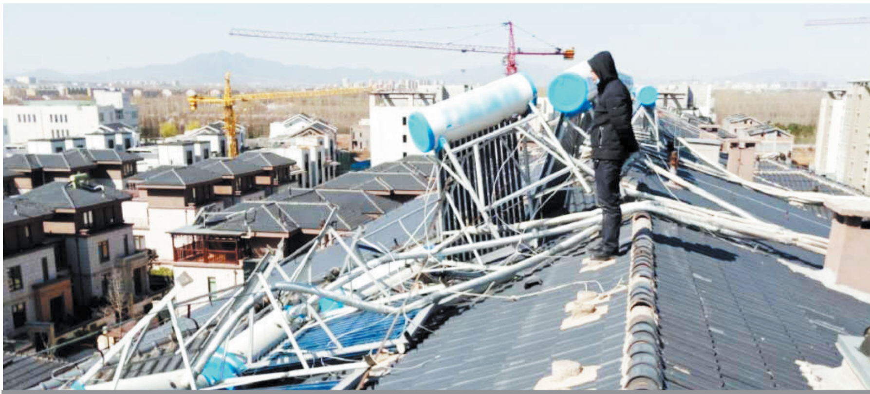
鲁王和墅小区的物业维修工正在楼顶查看被大风刮倒的太阳能热水器。
