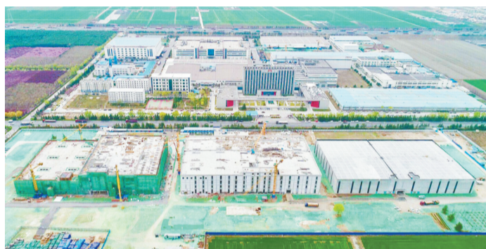
永聚科技国际新型医药包装材料科研生产基地正在施工。
