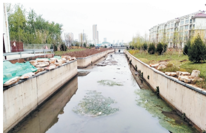
安康佳园内的排洪沟,目前河道护砌已完成,正在进行绿化施工。
