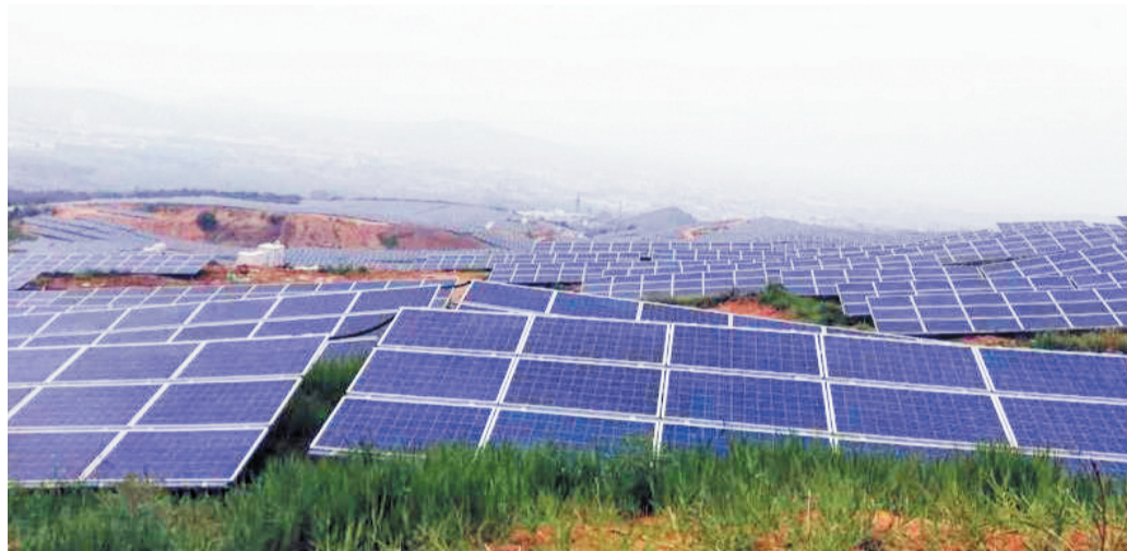
昆仑镇淄博光合新能源电厂一角。
