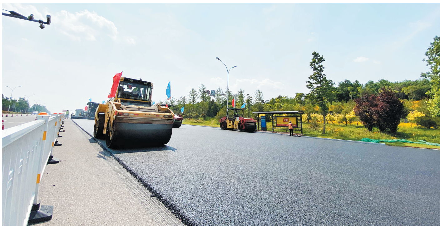
鲁山大道以西路段施工现场，几台大型摊铺机、压路机正在紧张工作。
