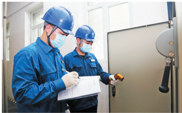
保电人员在考点巡视、检查配电设备。
