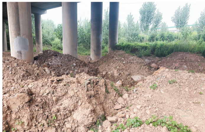
文昌湖区孔子文化园南侧高速路桥下大量露天堆放的渣土。
