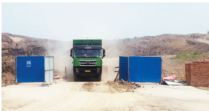
博山区万福路淄博琳赛姆新材料有限公司在建项目施工现场渣土车带起扬尘。
