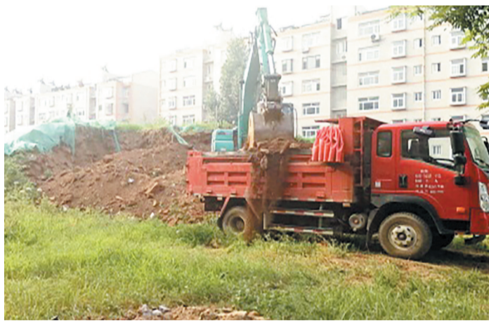
淄博经济开发区马庄村长期堆放的渣土。
