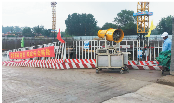
工地内的雾化机。
