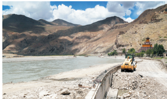
日吾其乡基础设施提升改造现场,江边的挡水墙已经颇具规模,仍有一部分正等待浇筑混凝土。
