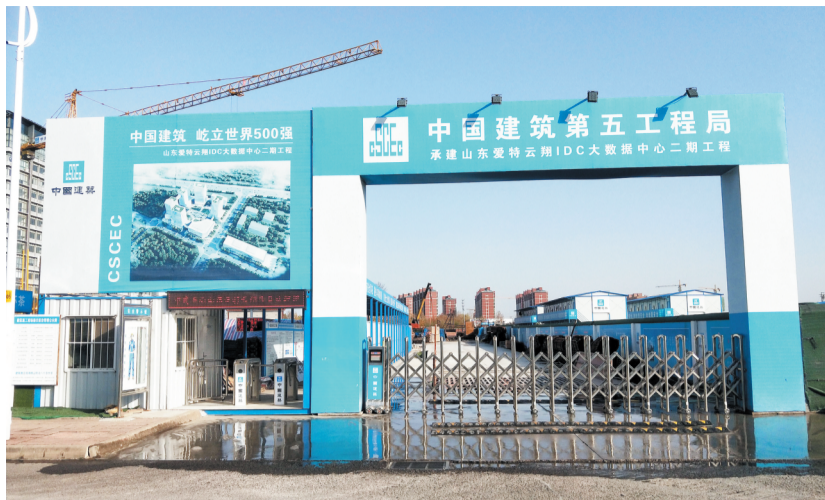
中建五局山东公司承建的山东爱特云翔IDC大数据产业园项目部。
