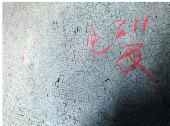
墙面大面积龟裂。
