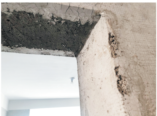
墙面防裂网外露, 墙角破损。
