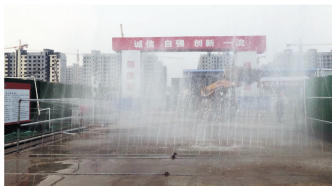
项目部洗车台。
