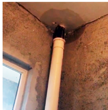
卫生间顶部管道渗水。
