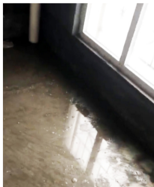
西侧阳台及下水管渗水。
