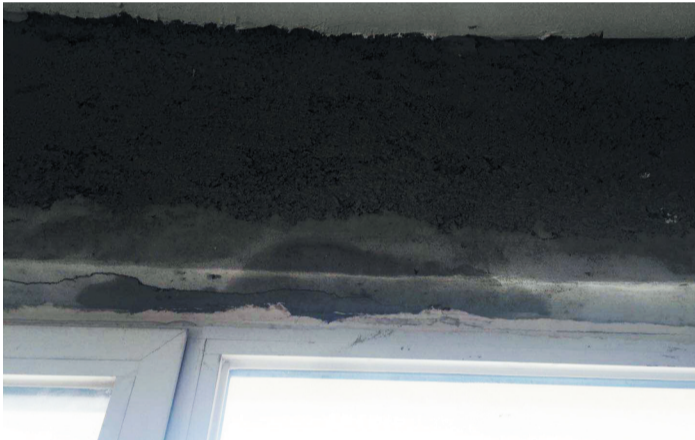
北卧室窗台墙皮脱落。
