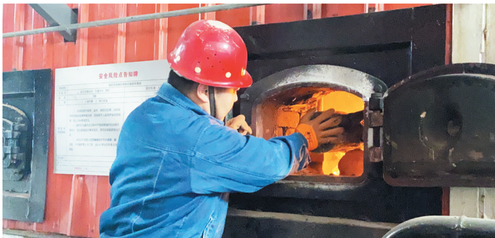
环保供热锅炉调峰热源现场，工作人员点燃了今冬“第一把火”。
