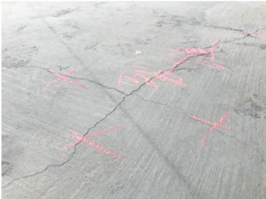
卧室地面上有多条裂缝。
