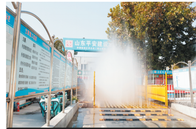
山东平安建设集团有限公司承建的正承名筑二期项目出入口设置汽车冲洗平台。
