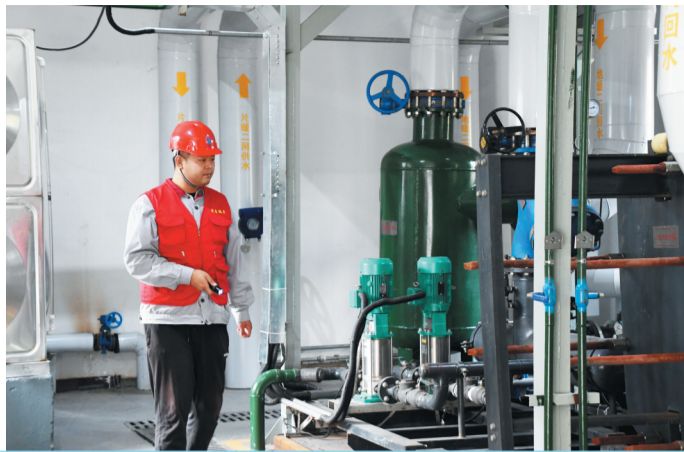
华星热力工作人员对管辖小区内的换热站进行日常巡检维护。
