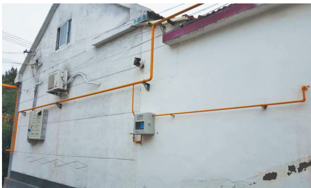
“气代煤”用户户外燃气管线。
