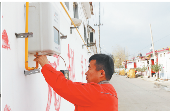
诚意燃气公司齐都镇营业所负责人陈大帅在村里检测燃气设施。
