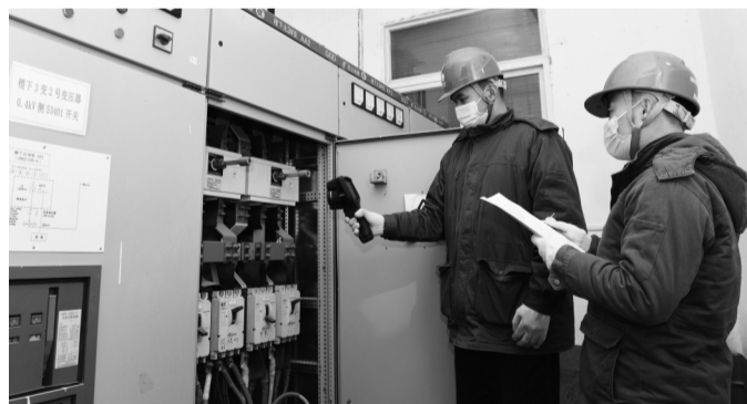
临淄供电中心高压客户服务班员工检查稷下南生活区配电室。
