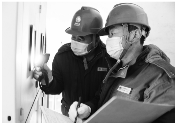
电力员工到客户配电室排查设备隐患。
