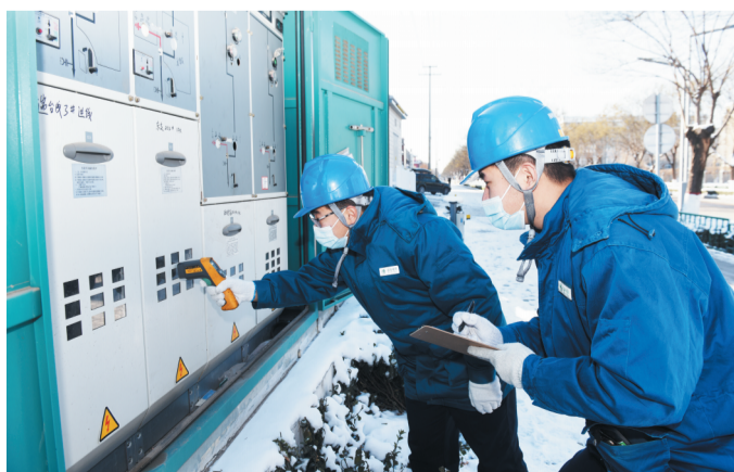
电力员工雪后巡视城区10千伏台区环网箱。
