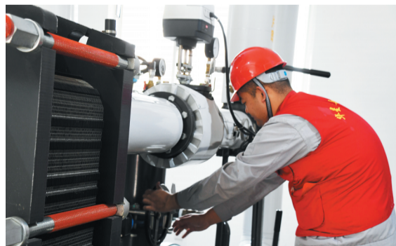
淄博华星热力有限公司工作人员在小区换热站进行日常检查。
