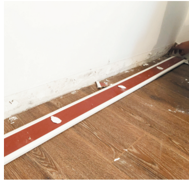
一名业主家中踢脚线脱落。
