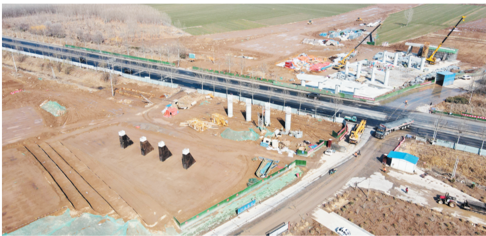
济高高速高青段施工现场，一派紧张忙碌的景象(无人机照片)。
