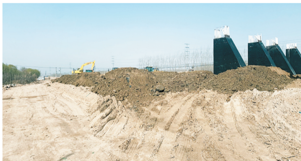
济高高速公路在建项目现场黄土裸露,无抑尘降尘措施。
