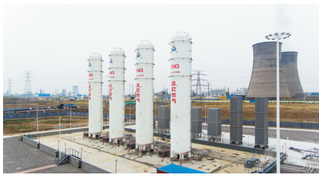
马桥化工产业园天然气能源中心
