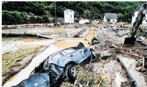
7月15日在德国舒尔德拍摄的在洪水中损坏的道路和房屋。 新华社发
