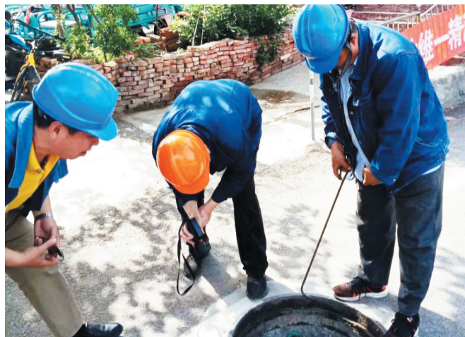
注水前,工作人员对阀门井内设施进行巡查。
