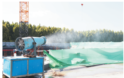
雾炮机正在喷出水雾。
