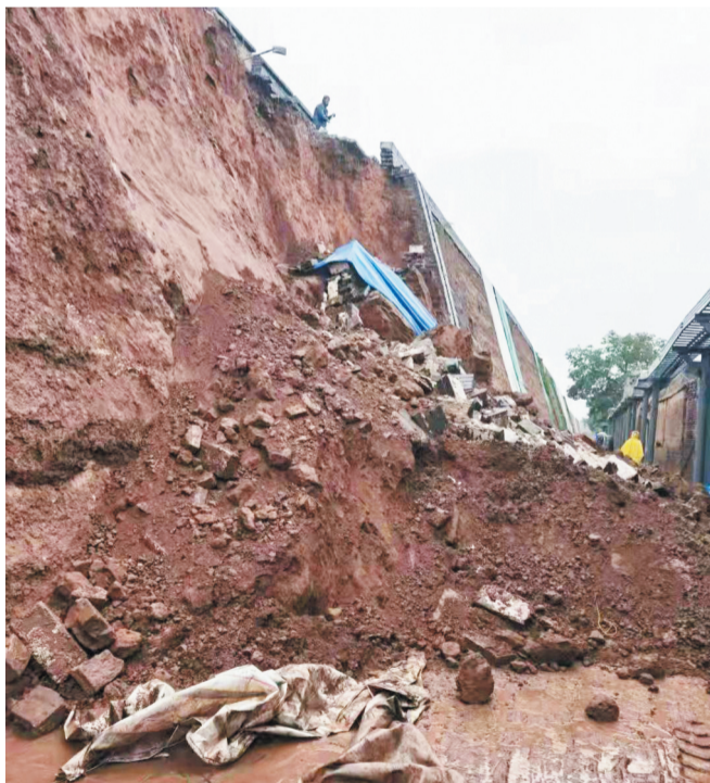
平遥古城墙局部坍塌。
