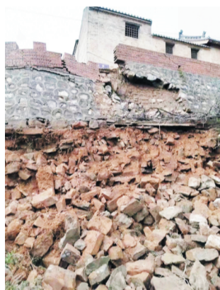
山西晋城市阳城县大夫街土地庙护墙坍塌。
