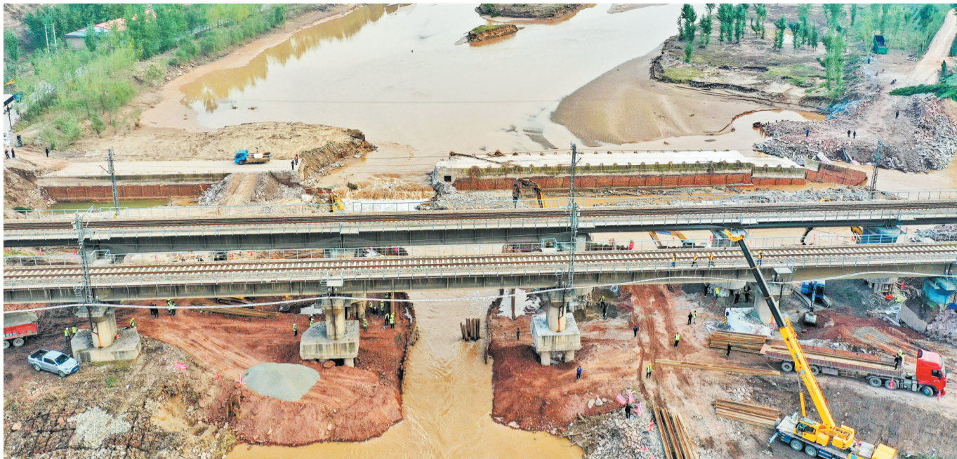
这是10月13日拍摄的南同蒲铁路昌源河大桥抢险现场(无人机照片)。新华社发
