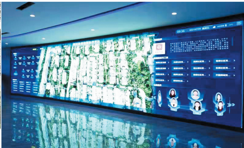
临淄区(雪宫)城市大脑综合指挥中心
