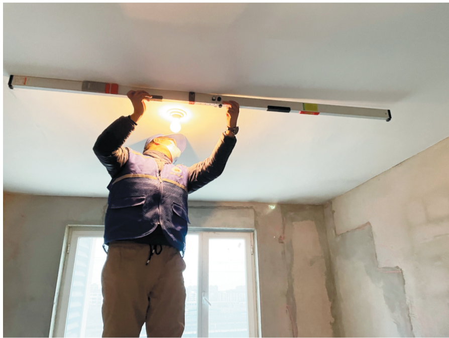
部分顶面平整度偏差约15毫米。
