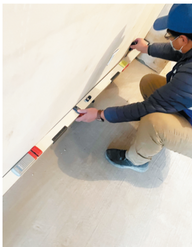
餐厅西墙面局部不平整，偏差约13毫米。
