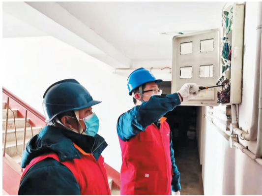
国网滨州无棣县供电公司彩虹共产党员服务队开展老旧小区供配电设备特巡活动，确保学生上网课和市民居家办公顺利进行。
