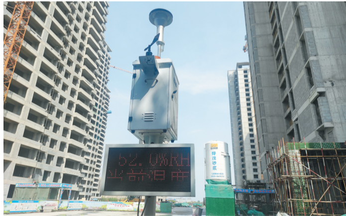
扬尘在线监测器实时更新显示多项数据。
