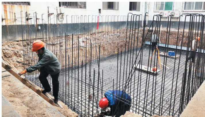
4月18日，张店区公园街道诚臻康养中心项目现场，施工人员正在进行养老机构内部消防设施的改造升级。
