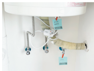
太阳能热水器没有排水软管。
