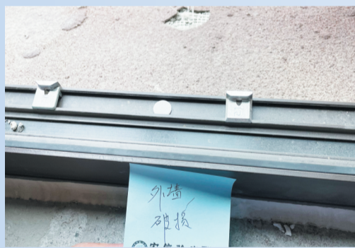
卫生间外窗台有破损。
