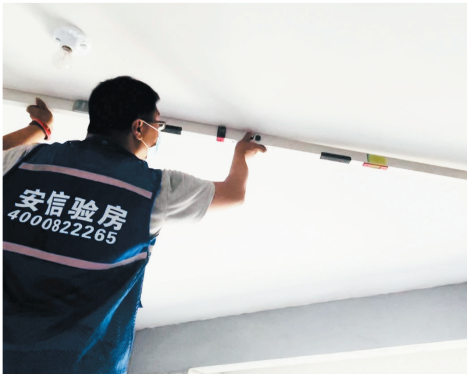
客厅顶面局部平整度偏差大于15毫米。
