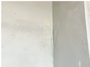
北卧室一处阴角不顺直,偏差约30毫米。
